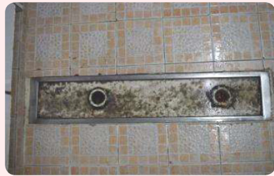
배수구에 덮개가 설치되어 있지 않음
